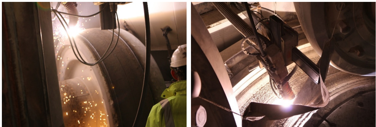
Abb. 9: Links: Schweißen einer Mahl-Walze mit Open-Arc-Fülldrähten in der VRM (Werksfoto WA) Rechts: Schweißen eines Mahltisches mit Open-Arc-Fülldrähten in der Mühle (Werksfoto WA)
